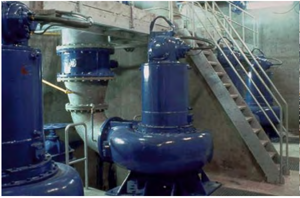
КНС с вертикальными насосами
