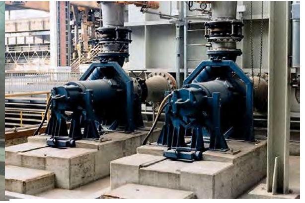
КНС с горизонтальными насосами
